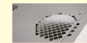
天井排気にダクトを付けることによって部屋に熱をこもらせません。
